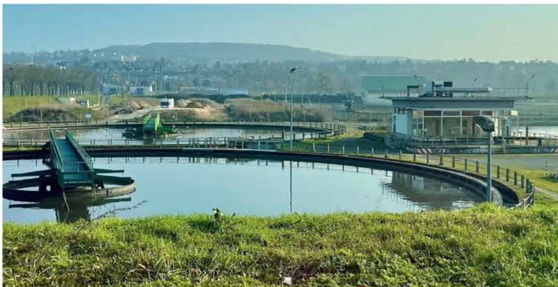
Saint-Germain-en-Laye, le 14 février. Les eaux usées d'une grande partie de l'Île-de-France convergent vers l'usine Seine-Aval. Elles y sont assainies avant leur rejet dans la Seine. LP/Sébastien Birden
