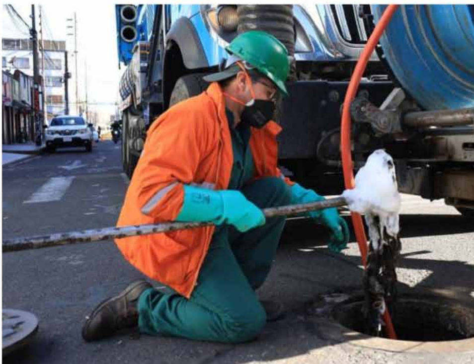
Botar condones en el sanitario genera graves problemas de taponamiento.
